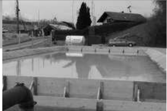
CO 2 -Speicherbehälter einer Baustellenneutralisationsanlage
