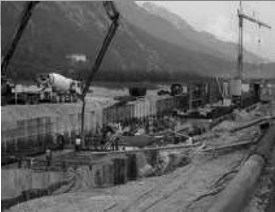
Rohrneutralisationsanlage auf einer Baustelle in Tirol
