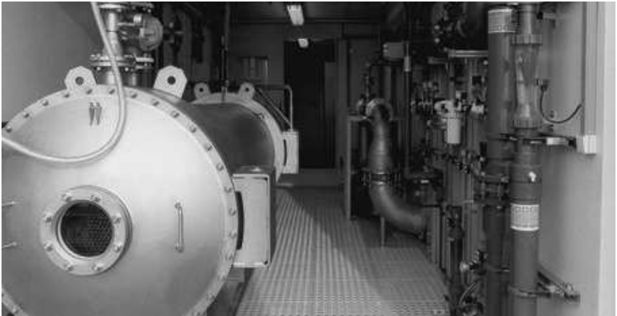
Abb. 8: Ozon-Anlage zur Abwasserteilstrom-Oxidation (Foto: Wedeco)
