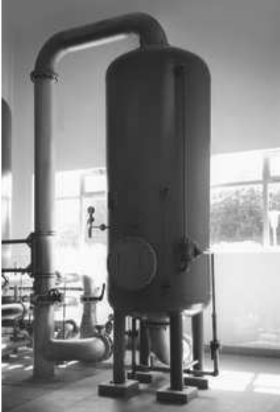
Abb. 9: Sauerstoffeintrag über einen Oxidator vor der Enteisung/Entmanganung
